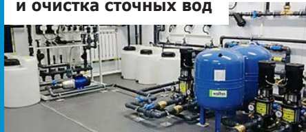
Комплексная водоподготовка и очистка сточных вод
