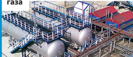
Установки подготовки газа
