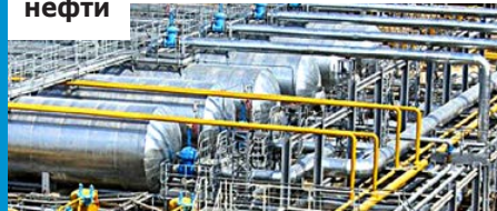
Установки подготовки нефти
