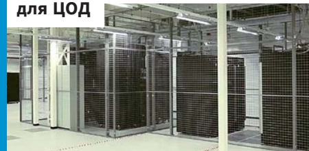
Оборудование для ЦОД
